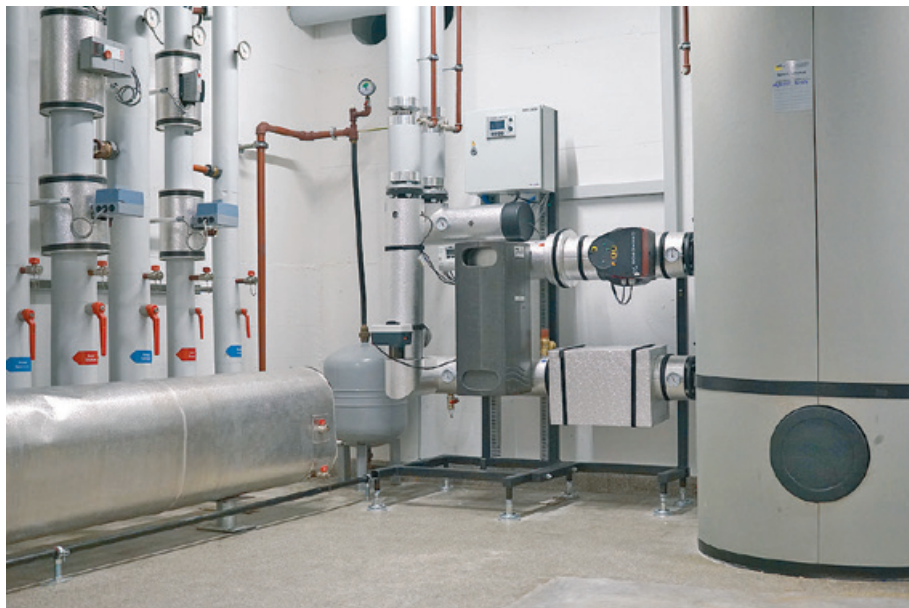
Der Fernwärmeanschluss der Oberstufe Lerchenfeld
