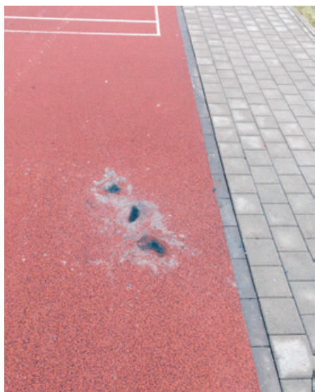
Durch das Zünden des Feuerwerks sind Schäden am roten Platz entstanden.
