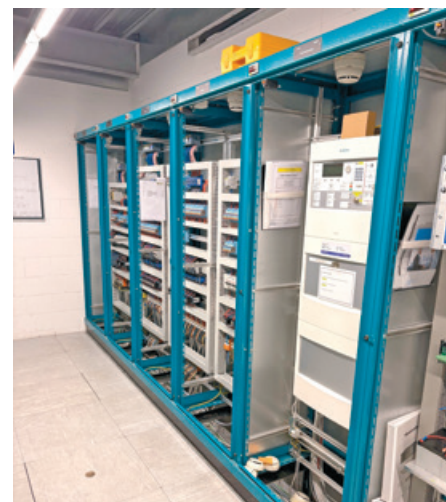
Schränke in der Unterverteilung: Eine Unterverteilung besteht aus mehreren Schaltschränken. Die ARA Bazenheid verfügt über eine Hauptverteilung und 14 Unterverteilungen. Eine Unterverteilung besteht aus 5 – 20 Schaltschränken
