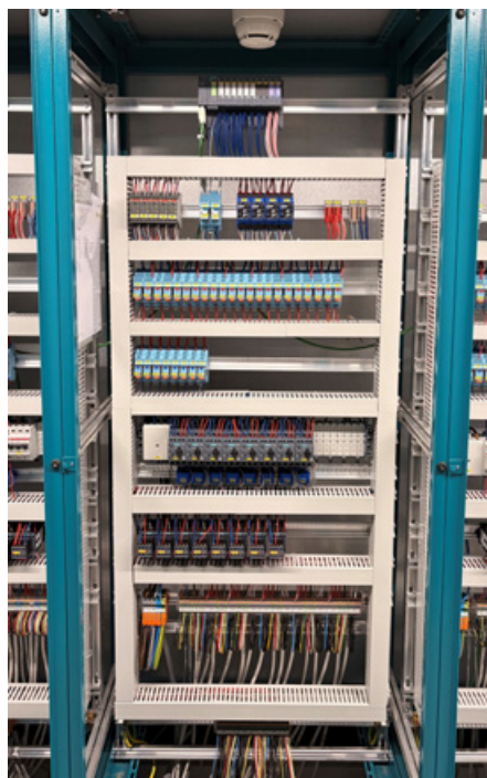
Schaltschrank in der UV
